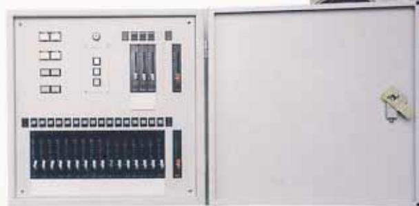
照明操作パネル
