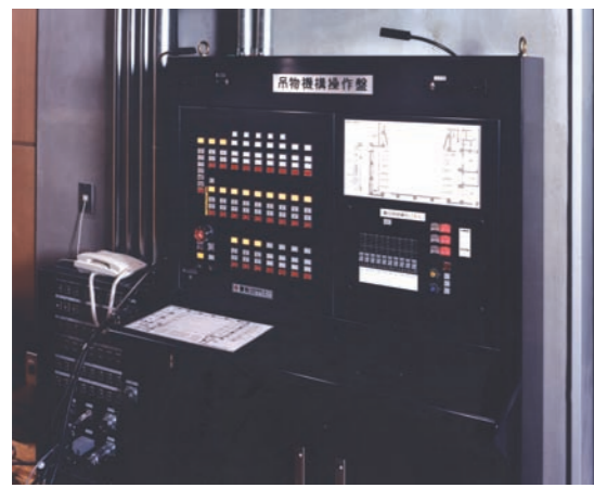
吊物機構操作盤
