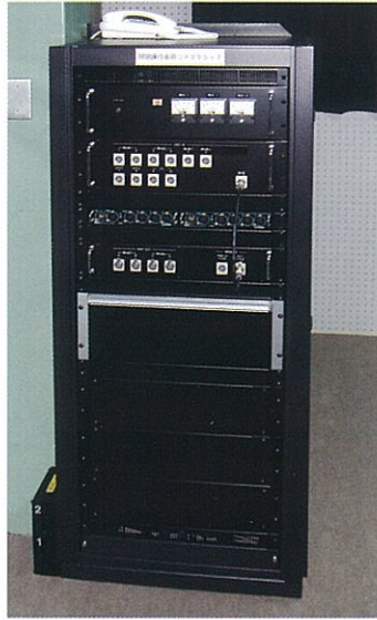
調光操作卓用コネクタラック (新設)
