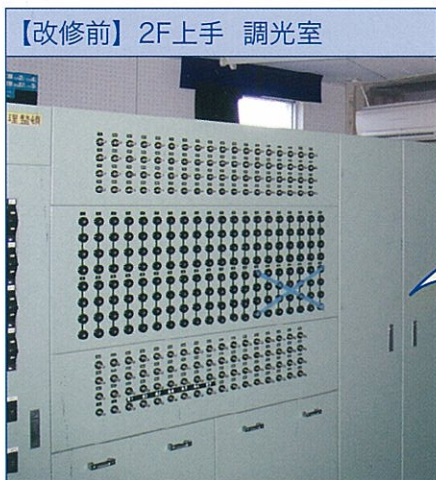
■ 改修前/主幹盤・調光器盤・負荷分岐盤 ・パッチ盤(アナログ方式)
