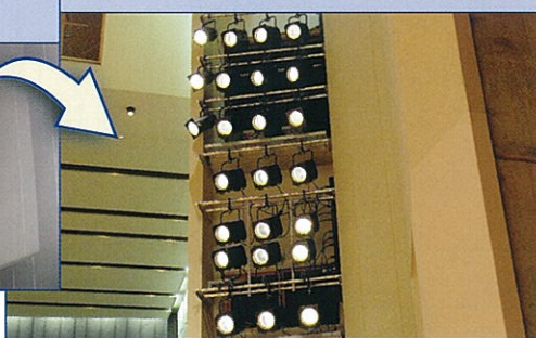
■改修後 ・C型20A・30Aコンセントに改修 (アース付) ・コンセントダクトの改修 ・回路増設 ・1kWハロゲン球 平凸レンズ新型スポットライトに交換。 ・フロントサイドライトのボタンとスポットライトの増設で、前明かりが充実。
