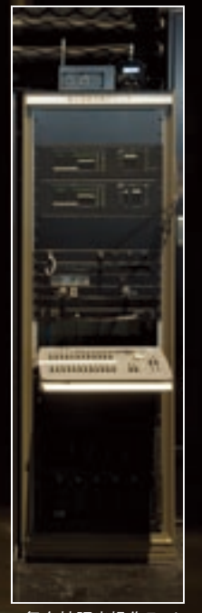
舞台袖調光操作ラック
