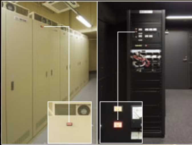
主幹盤・調光器盤室 警告表示灯 警告表示灯 調光室HUBラック
