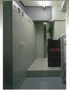
主幹盤・調光器盤・HUB ラック
