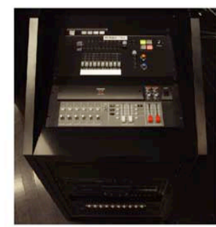
照明操作パネル (音響ワゴン組込)
