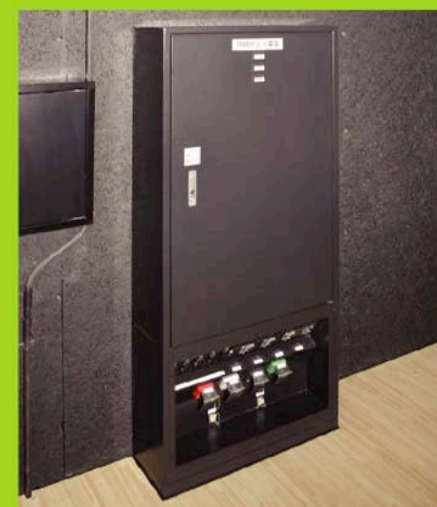
照明持分電盤
