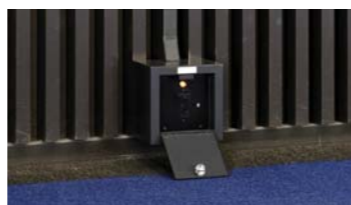
■客席ウォールコンセント(新設)
