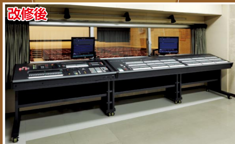
10 照明操作卓 F153 更新
