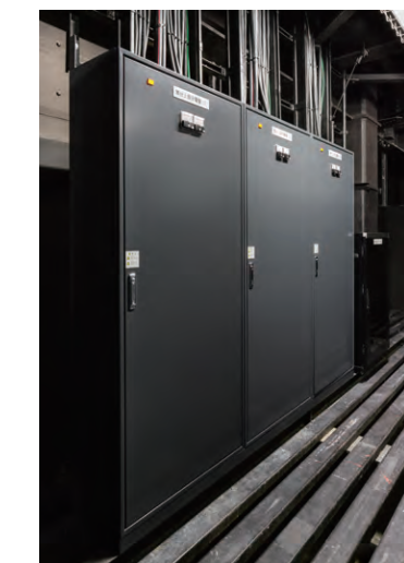
舞台上部電源盤
