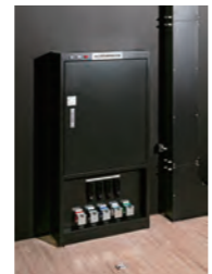
■持込照明機器電源盤
