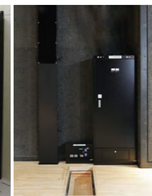
持込照明機器電源盤
