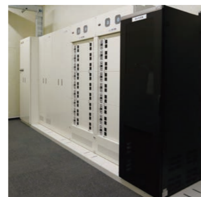
主幹盤・分岐盤・調光器盤・調光制御ラック
