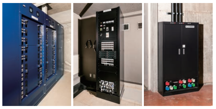
主幹盤・調光器盤 交換 コネクタラック 新設 舞台袖持込機器用電源盤 新設
