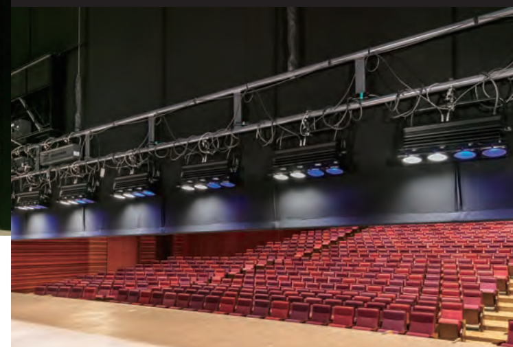
LEDフラッドライト SX-4 (32台設備)
