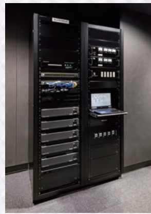
照明調整室ネットワークラック
