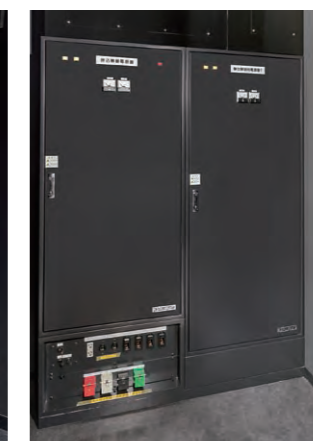
持込機器電源盤・舞台照明用電源盤※
