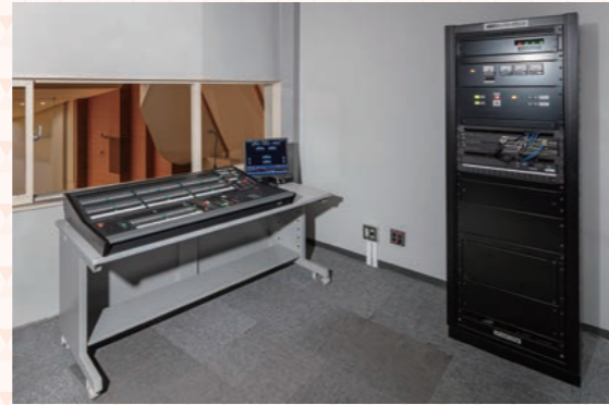
調整室ネットワークラック 新設 ※
