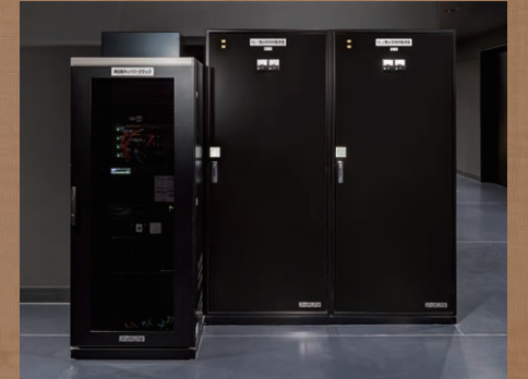
舞台照明用電源盤・舞台袖ネットワークラック※
