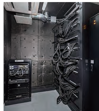
調光盤室ネットワークラック・移動形調光器接続盤
