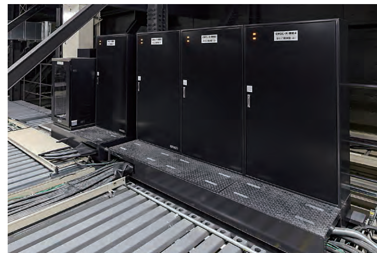
すのこネットワークラック・すのこ電源盤
