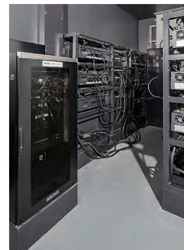
舞台袖ネットワークラック・移動形調光器接続盤
