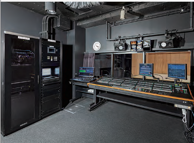
調整室ネットワークラック
