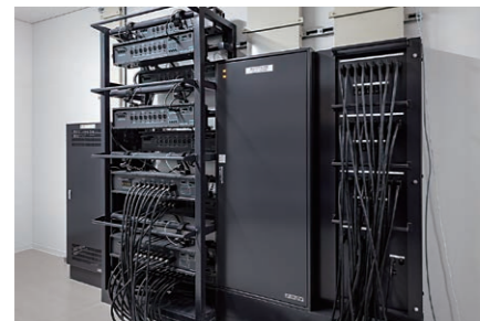
舞台袖ネットワークボックス・移動形調光器・フロア回路接続盤・舞台照明電源盤
