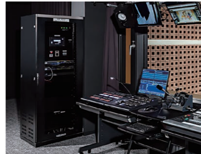
調光室ネットワークラック
