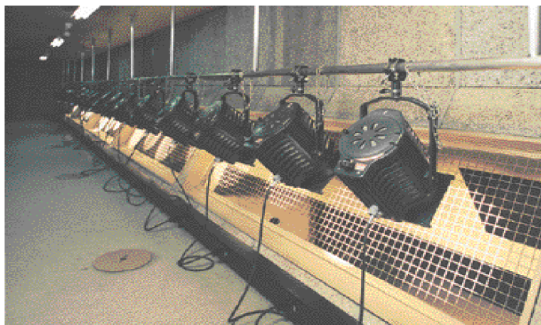
第1シーリングスポット室
