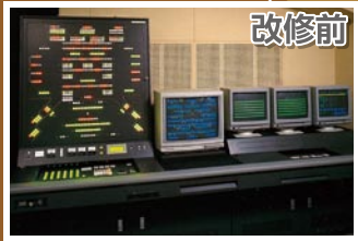
改修前はデジタルクロスバを設置
