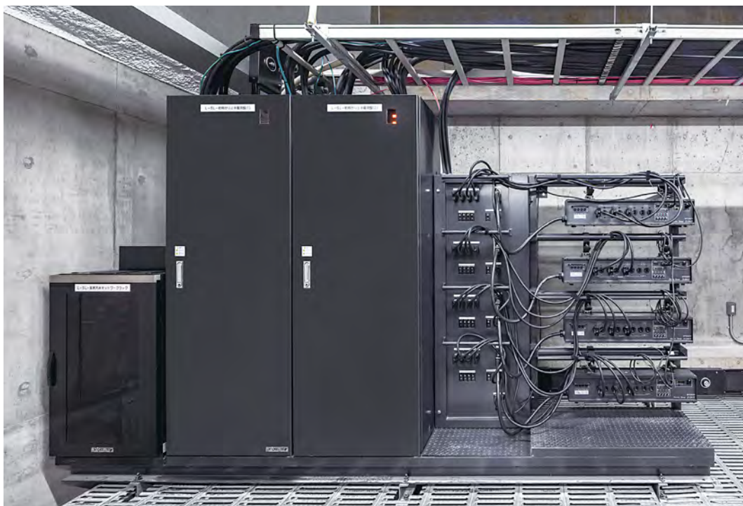
客席天井ネットワークラック・前明かり電源盤・移動形調光器接続盤
