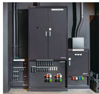
持込照明機器電源盤
