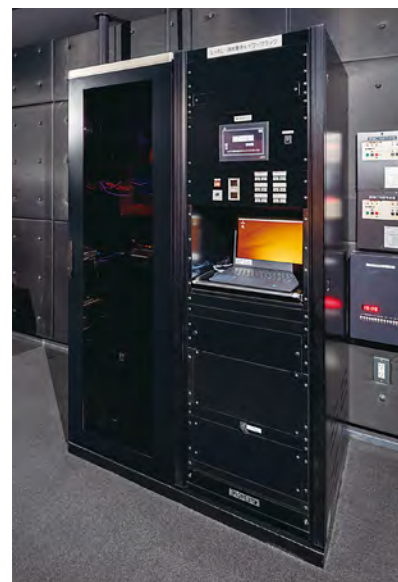
調光室ネットワークラック
