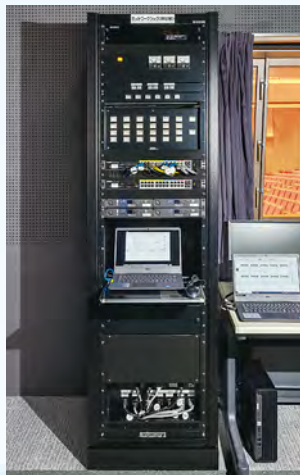
調光室ネットワークラック
