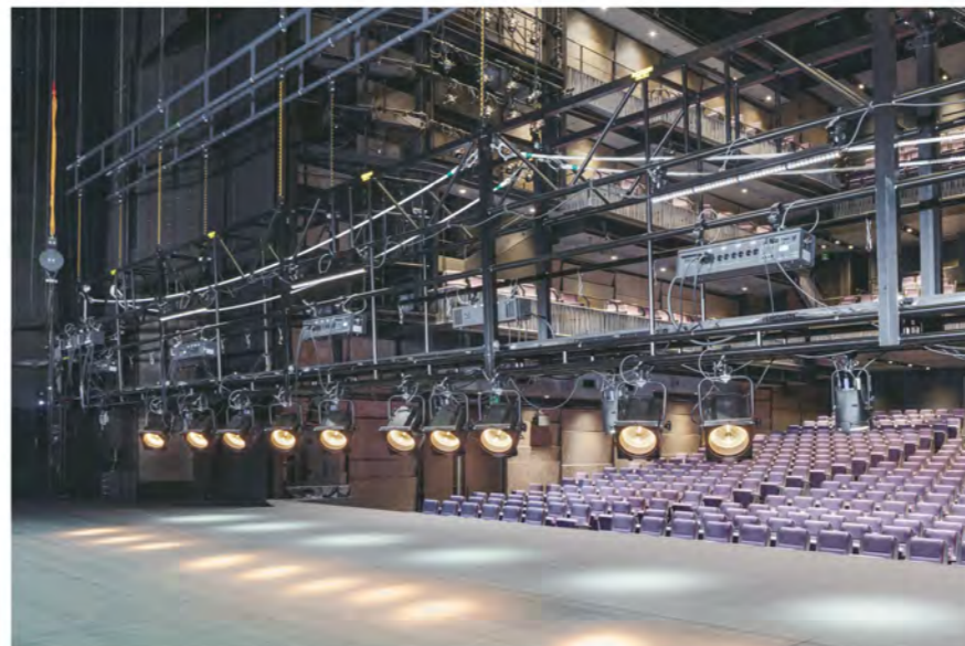
移動照明トラスユニット
