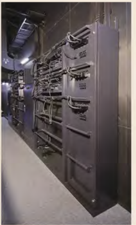
2階舞台照明用電源盤 移動形調光器接続盤
