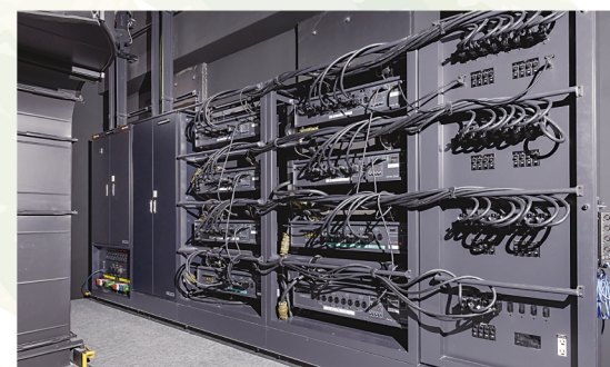
持込機器電源盤・フローア用移動形調光器接続盤
