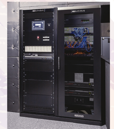
調光室ネットワークラック
