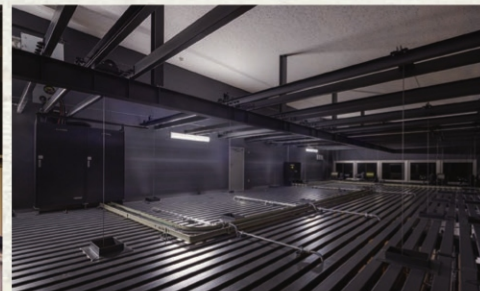
二段スノコ：照明電源盤と吊物設備
